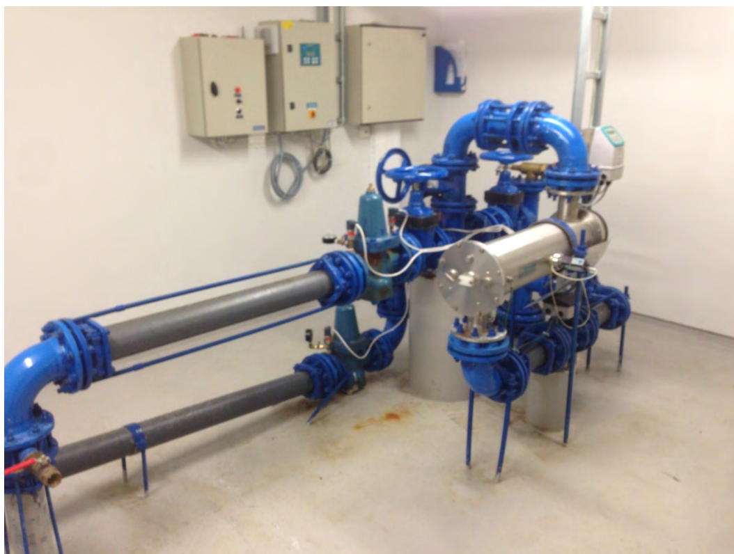
Bilde 4-3, viser UV- anlegget i Haugvika
