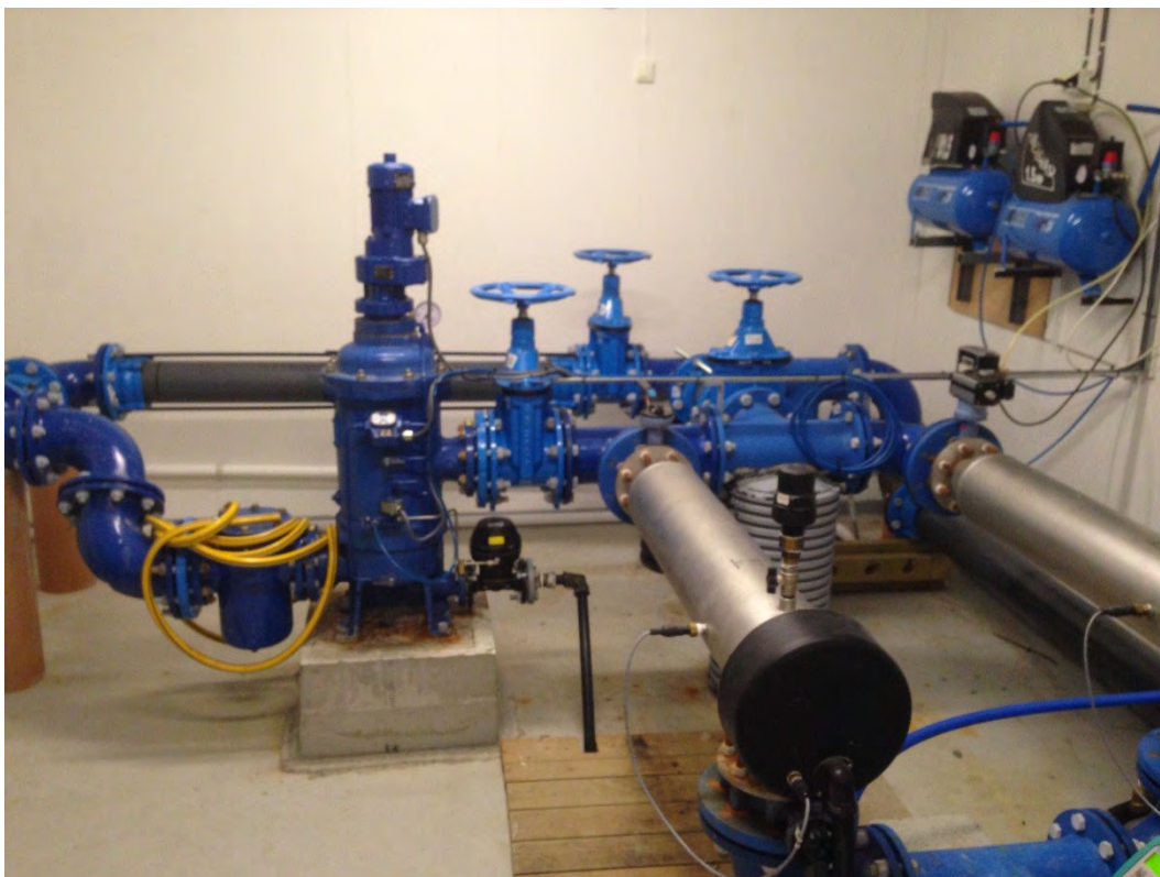
Bilde 4-6, viser UV anlegget i Halså vannverk.
