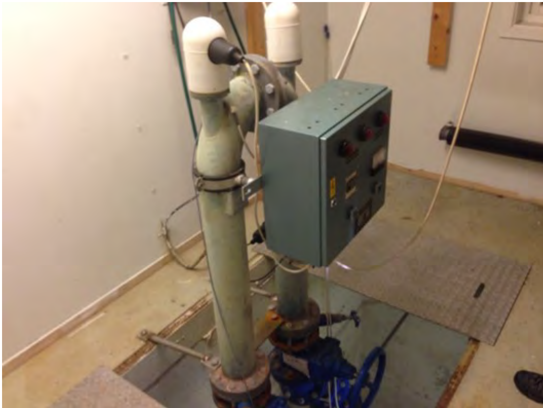
Bilde 4-4, viser UV-anlegget i Vassaksla
