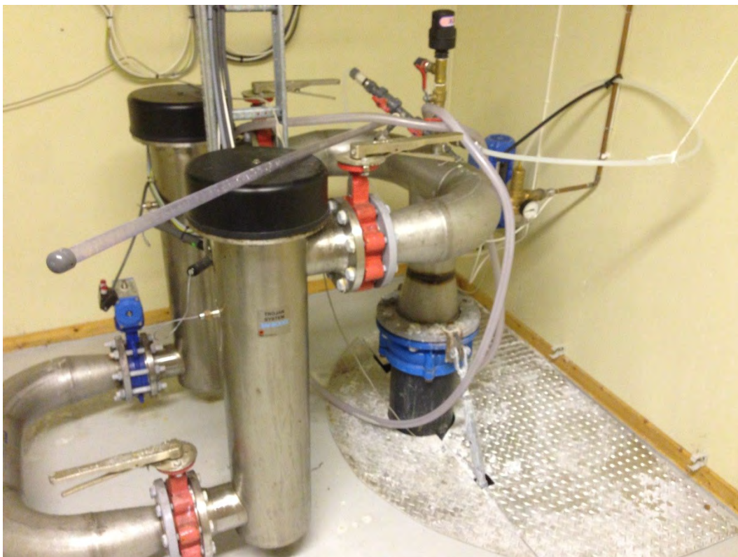
Bilde 4-7, viser UV-anlegget i Vassdal vannverk.
